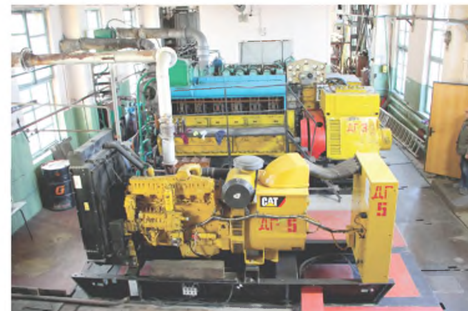
Установленная мощность – 1968 кВт. Генерирующее оборудование: четыре дизельных генератора марки «Caterpillar 3406» мощностью 292 кВт каждый, один дизельный генератор марки «22ДГ» мощностью 800 кВт. Протяженность линий – 27,69 км.
